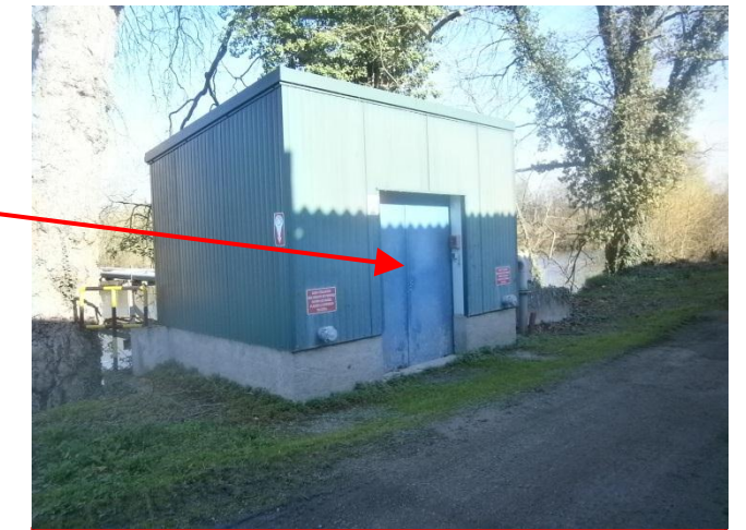
Vanne d'isolement + coupure électrique d'approvisionnement en eau
